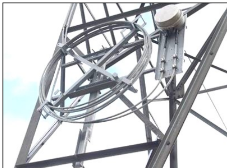
Kveilekruss med Tykoflex skjøteboks, OPGW festet med Mastefeste 402920/1
