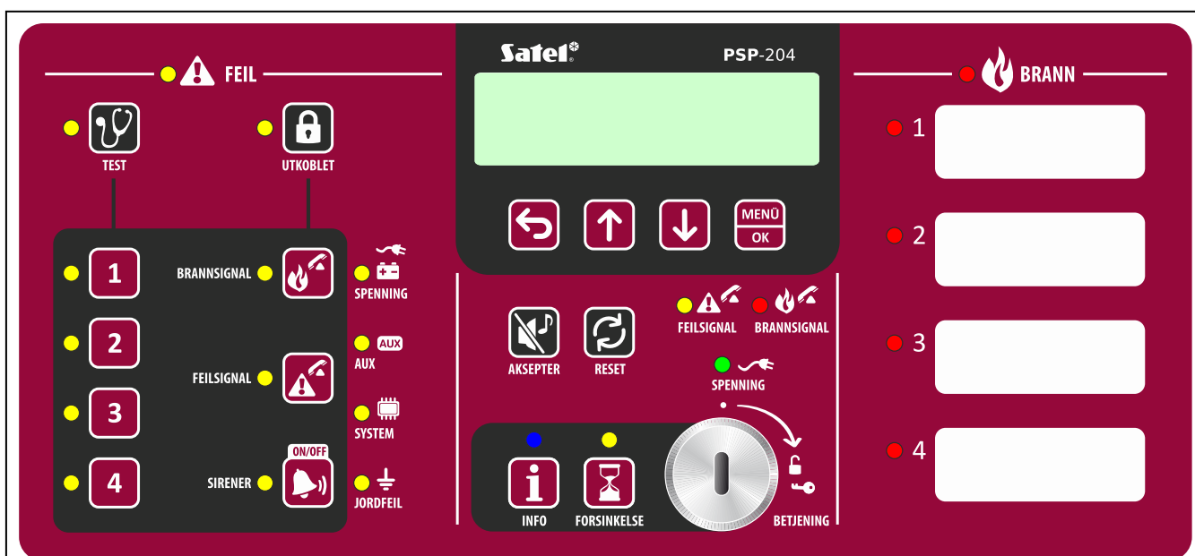
Fig. 5. Fronten til et PSP-204 tilleggspanel.
