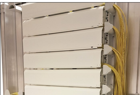
Merkeplater i rack
