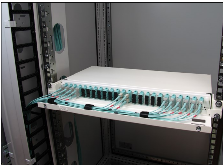
Panel med kabelrenne i standard 19" skap
