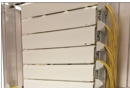
Merkeplater i rack
